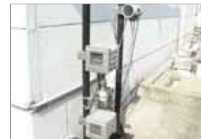
③ 排水管理用総合モニタリングシステムの1つである連続監視pH計
