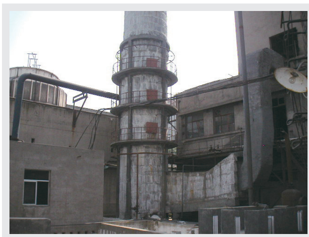
図2 脱硫塔 一般工場
