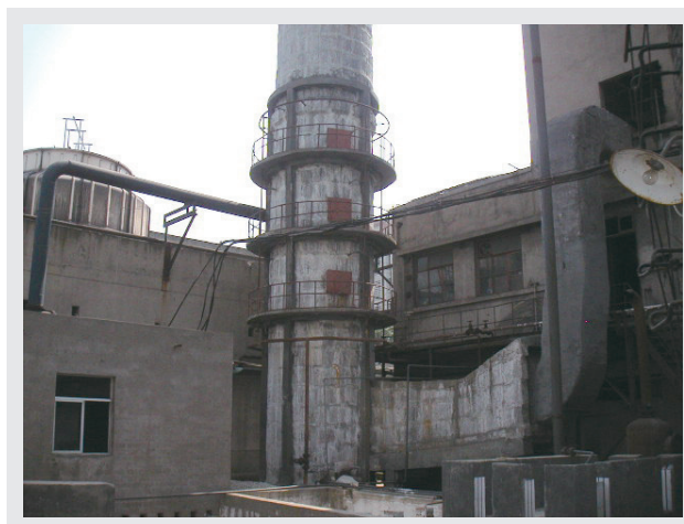
図2 脱硫塔 一般工場
