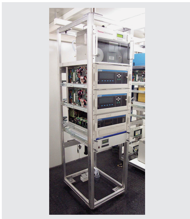
図1 AP-360搭載の環境大気モニタリング・システム Reykjavik( Iceland )ネットワーク・ステーションの室内 (2002年納入)
