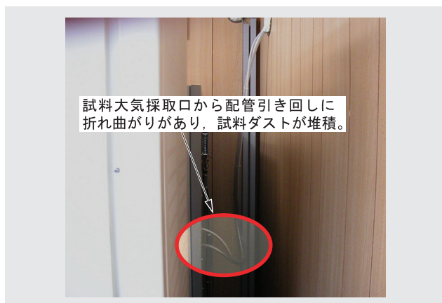
図5 測定局舎内の試料導入配管折れ曲がり部の試料ダスト堆積
